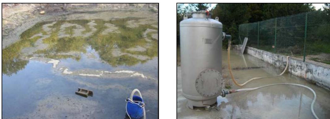
Pompage et traitement des eaux du bassin
